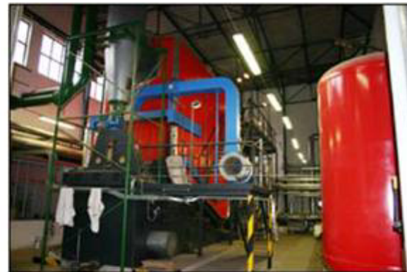
Pohled na instalovaný kotel.
