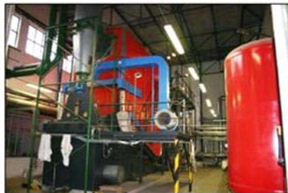
Pohled na instalovaný kotel.
