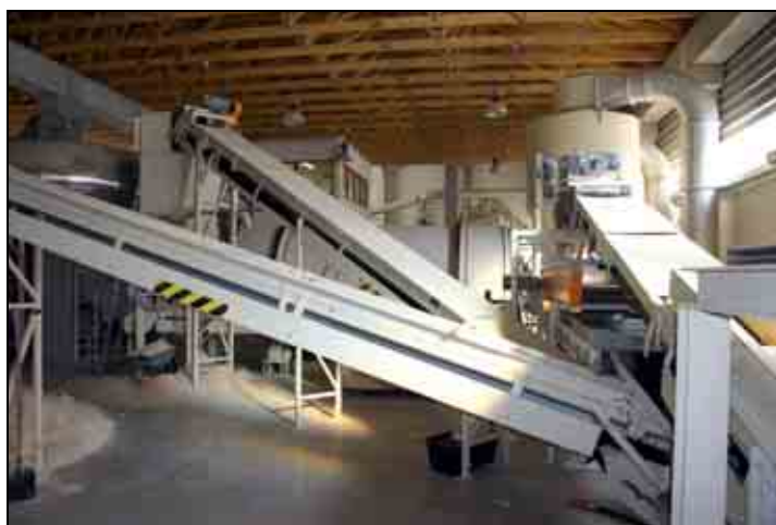
Obrázek 18 - Pohled na moderní velkokapacitní peletizační linku pro výrobu dřevěných pelet v Kysuckom Lieskovci (Slovensko).
